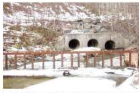
Figur 4.20. Eksempel på rist i forkant av stikkene for å fange opp sedimenter, greiner og søppel. De tre stikkene er lagt i forskjellig høyde for at minst en av dem skal være fri for is og sedimenter i forbindelse med flom. Raabe, Døvrebanen, Østø, H. Sprens.
