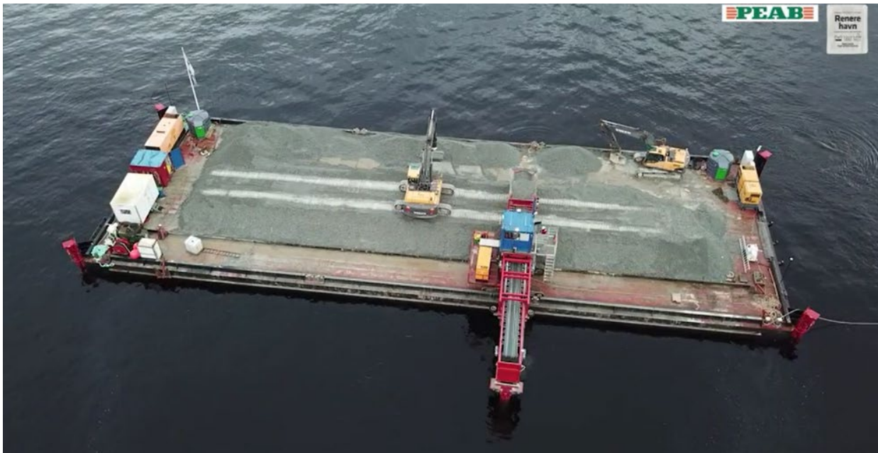
Figur 6: Tildekkingslekter Recto. Dette fartøyet ble brukt på brorparten av tildekkingsarealene ved tildekking av forurenset sjøbunn i Indre havn Horten.
