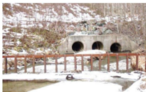
Figur 4.20: Eksempel på rist i forkant av stikkrenne for å fange opp sedimenter, greiner og søppel. De tre stikkrennene er lagt i forskjellig høyde for at minst en av dem skal være fri for is og sedimenter i forbindelse med flom. Radda, Dovrebanen. (Foto: H. Noren).
